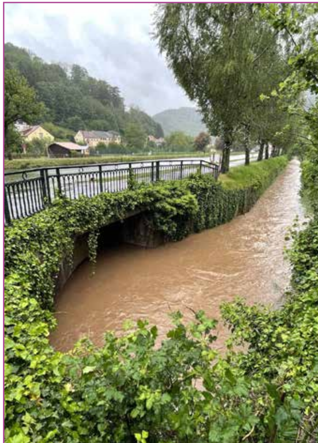
Passage du Trimbach dans les buses sous le canal
